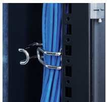
Guide câbles vertical
