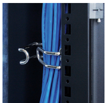
Guide câbles vertical
