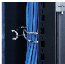
Guide câbles vertical
