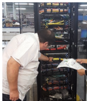
Vérification des câblages et des schémas
