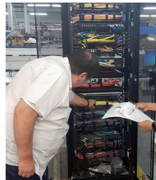
Vérification des câblages et des schémas
