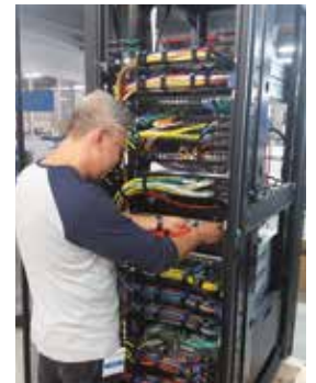
Câblage de baie
