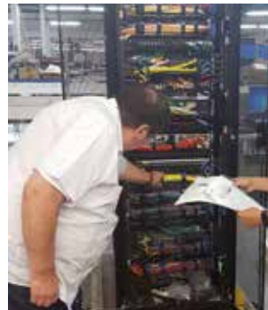
Vérification des câblages et des schémas
