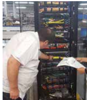
Vérification des câblages et des schémas
