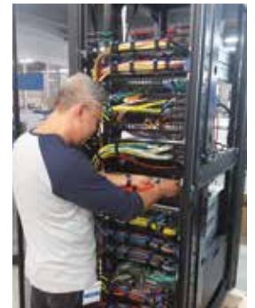
Câblage de baie
